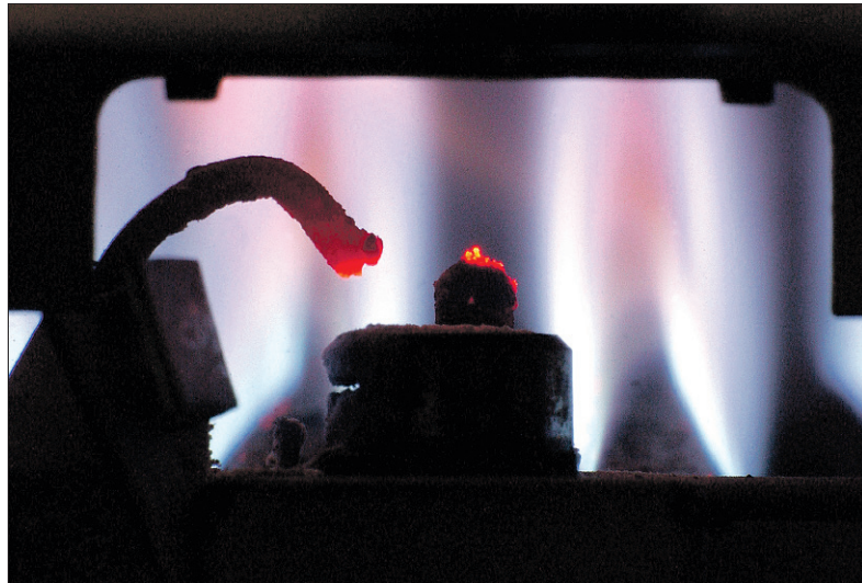
Wenn die Gasetagenheizung aufhört zu funktionieren, beginnt der Streit, wer für die Reparatur oder den Austausch aufkommen muss. [PA/Norbert Försterling]
